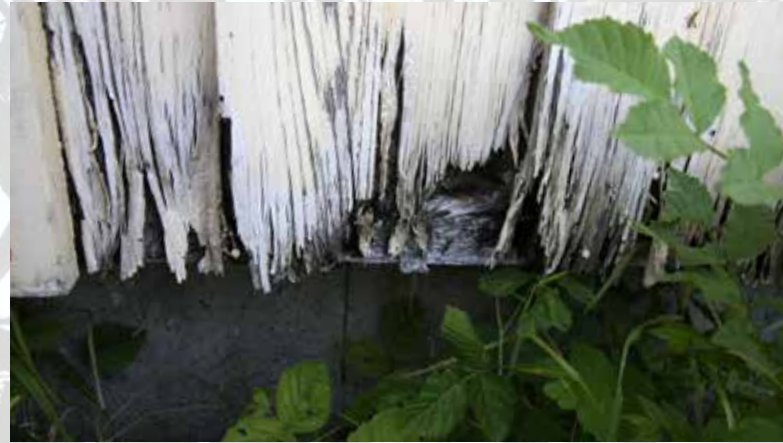
Defekte Fassade mit nicht zeitgemässer Wäremedämmung
