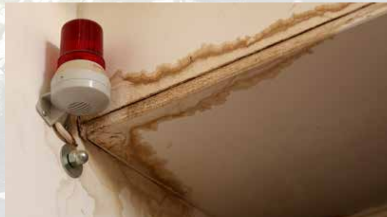
Undichtes Dach (Totalsanierung nötig)
